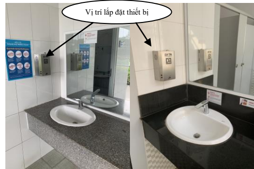
Hình 8: Thiết bị lắp đặt thực tế tại khu B và C.
